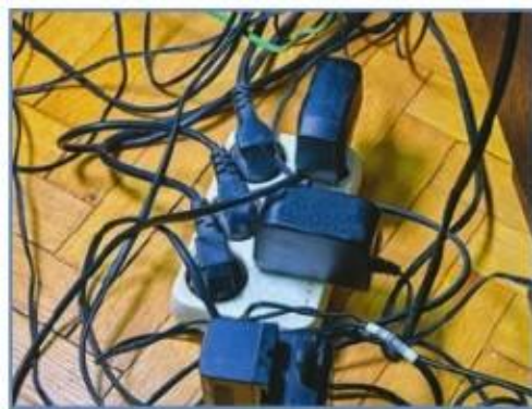
Нельзя подключать несколько мощных потребителей электроэнергии в один удлинитель
