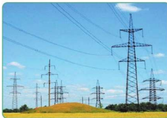
Рис. 71. Высоковольтная линия электропередачи
